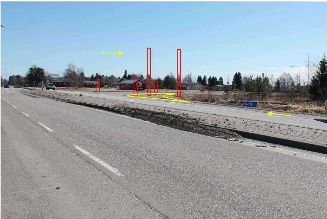
Kohta 4/kuva 8. Kääntyminen tieltä 8 tielle 27. Merkityt valopylväät (puuttuu 2 kpl) ja merkit (puuttuu) on poistettava. Merkitty alue on täytettävä.
