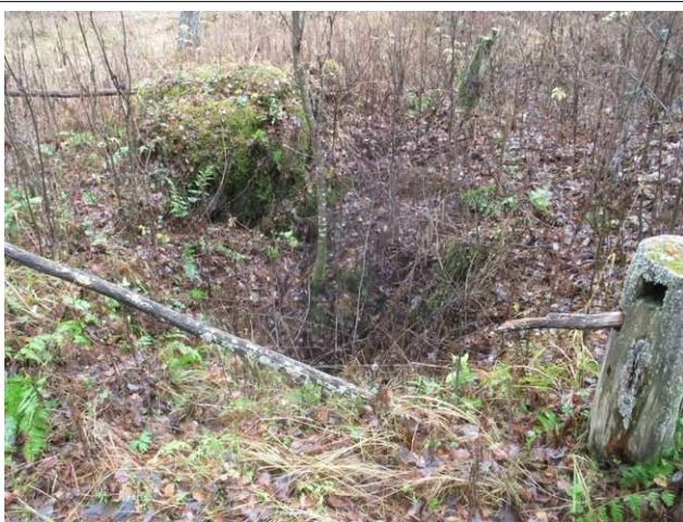
Alakohde 2-5: Kaivo lahonneine turvakaiteineen. Kuvattu luoteeseen.
